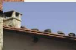
Les rives de toit en pignon seront traitées par un simple débord de tuiles creuses courantes. Les tuiles à rabat, les ouvrages de zinguerie sont à éviter.
